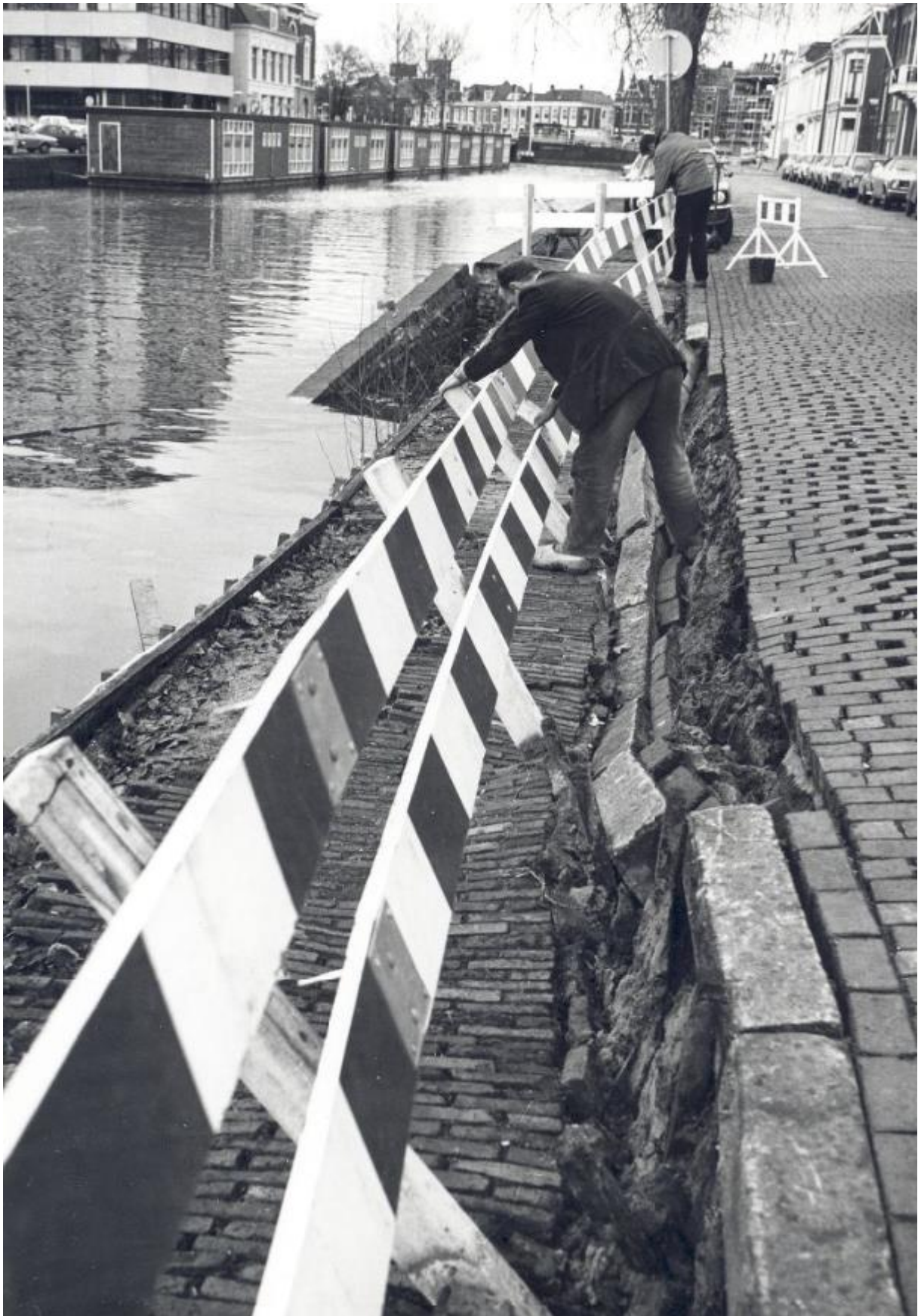
Verzakking van de walmuren aan de Willemskade zuidzijde, 1976. Bron: HCL, FDWILSKAA118.
