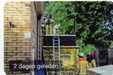
112Brabant Dak brand tijdens werkzaamheden ...
